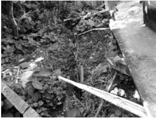
Figura 1 – Lançamento de esgotamento sanitário diretamente no córrego em área de manancial (foto do autor).
